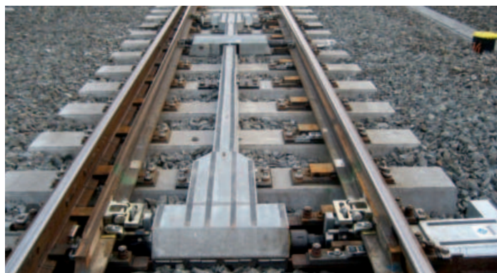
Innenliegendes Kraftübertragungsgestänge PGS mit Verschlusssystem „Sperlock“ und in die Schwelle integrierten Weichenantrieb „Ecostar“ (Foto: Voestalpine).
